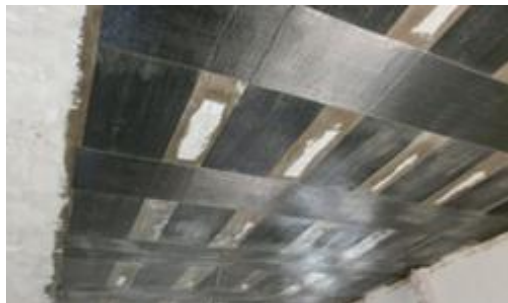
Усиление перекрытий Общежитие ФГОУ «Военно-технического училища при Спецстрое России», МО, г. Балашиха
